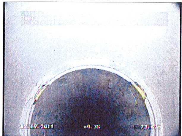
VCR Nr: 1_3B 73,95m, Przeszkoda przy spoinie, 10 % brak wysokości/średnicy
