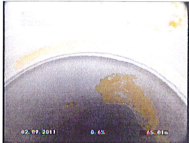
VCR Nr: 2_2B 64,98m, Przeszkoda przy spoinie, 10 % brak wysokości/średnicy
